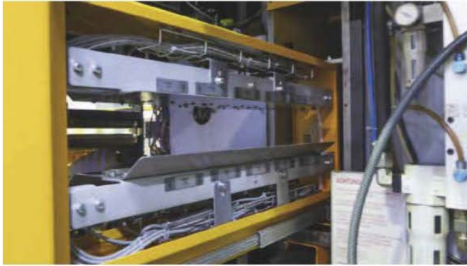
Blick auf die herausgehobene Sprühkammer: Sie enthält alle zur Versorgung der Band-Befettung notwendigen Leitungen und Anschlüsse für das Medium, Luftdruck und Elektrik.
